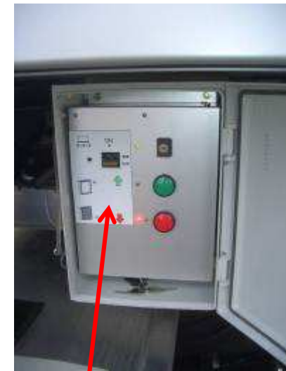
Poste de commande
